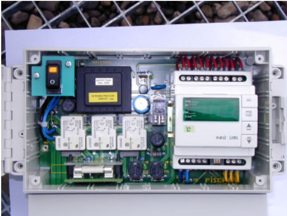
Bild 10: Schaltschrank für Einzelanlage, Werkbild Fischer
