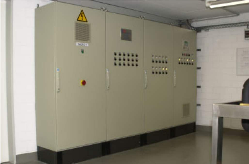
Bild 9: Schaltschrank einer Verbundanlage
