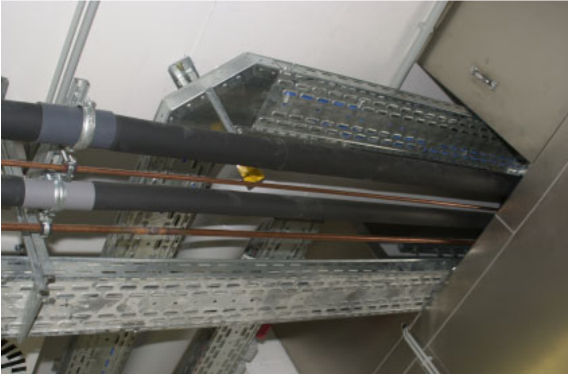
Bild 12: Beispiel einer Installationstrasse mit isolierten Saugleitungen und Flüssigkeitsleitung; parallel geführte Elektrotrasse
